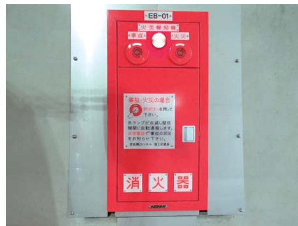
手動通報装置・消火器箱
