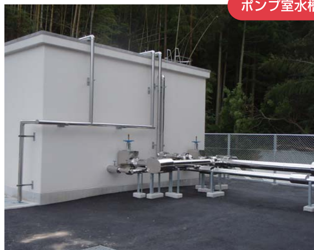
ポンプ室水槽
