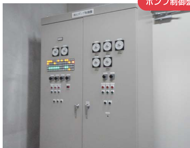
ポンプ制御盤
