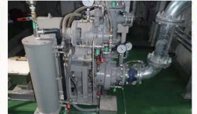
鳥取河川国道事務所 蒲生消雪ポンプ
