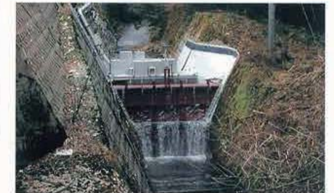
広島国道事務所 共同溝ポンプ
