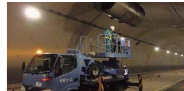
愛宕山トンネル・換気設備
