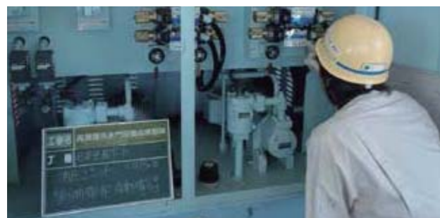
太田川河川事務所管内・高瀬堰右岸魚道ゲート
