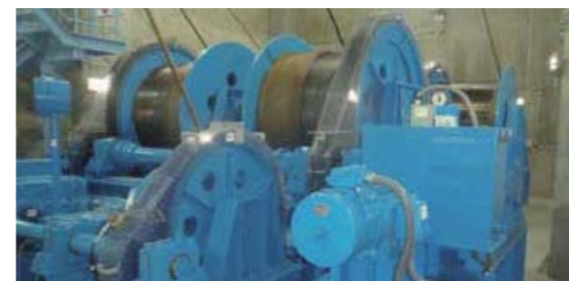
苫田ダム・選択取水設備
