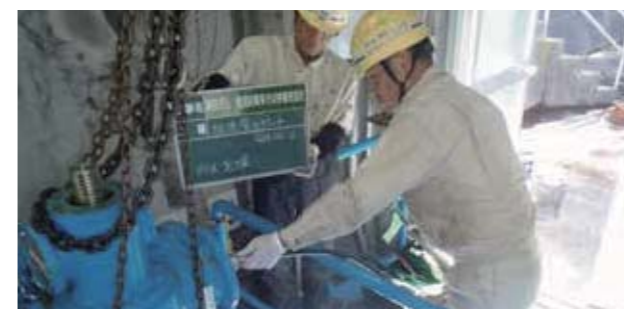
美田ダム・放流管主ゲート
