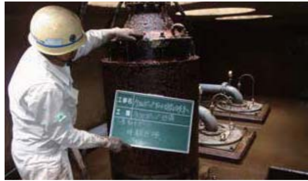
矢田ポンプ場・ポンプ設備
