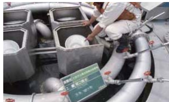
土師ダム・噴水設備
