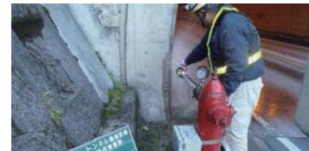
熊野トンネル・消火設備
