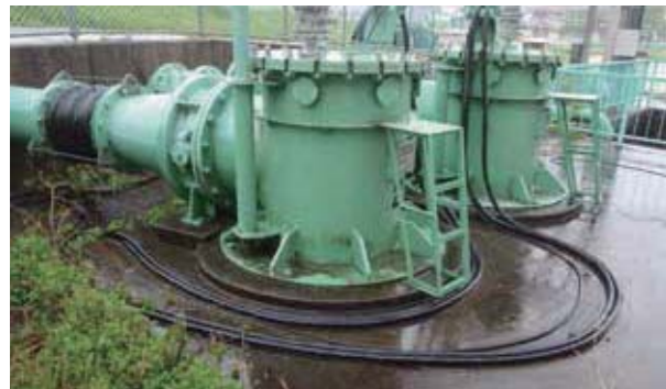
戸坂排水機場・ポンプ設備
