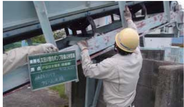
戸坂排水機場・除塵設備
