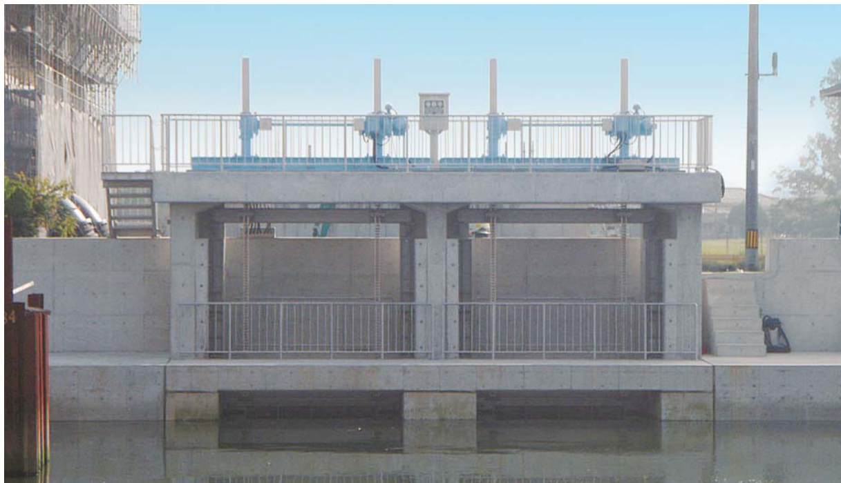
山口県防府土木事務所 (3.50m×2.50m×2門)
